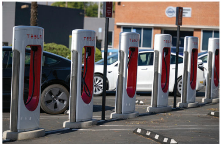
ESTACIONES DE SOBREALIMENTACIÓN DE VEHÍCULOS ELÉCTRICOS TESLA EN UN ESTACIONAMIENTO EN SAN FERNANDO.
